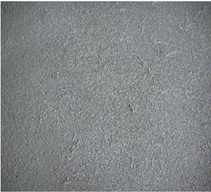
Struktura hotového povrchu potěru, s patrnými vlákny
